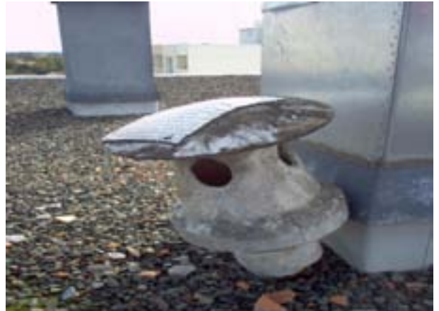
Conduit de fluide (air) ventilation haute
