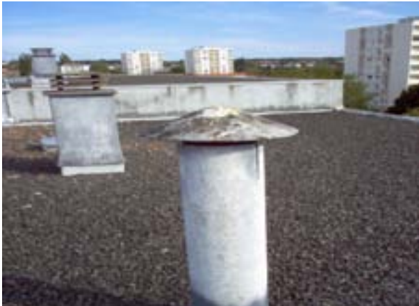
Conduit de fluide (air)
